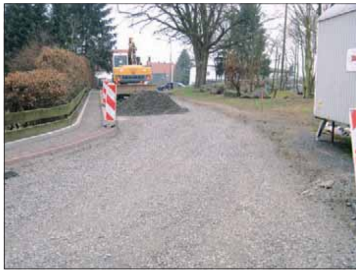
Die Erschließungsarbeiten für das Neubaugebiet »Sandäcker II« und die Straße »Am Hassenberg« laufen auf Hochtouren.
